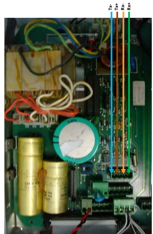
Nuovo Pignone dispenser board
